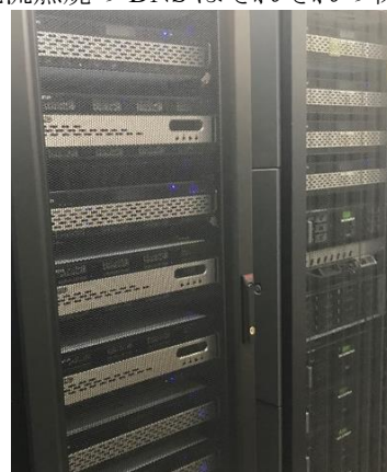
写真3 総容量 500TB 超のデータサーバー群
